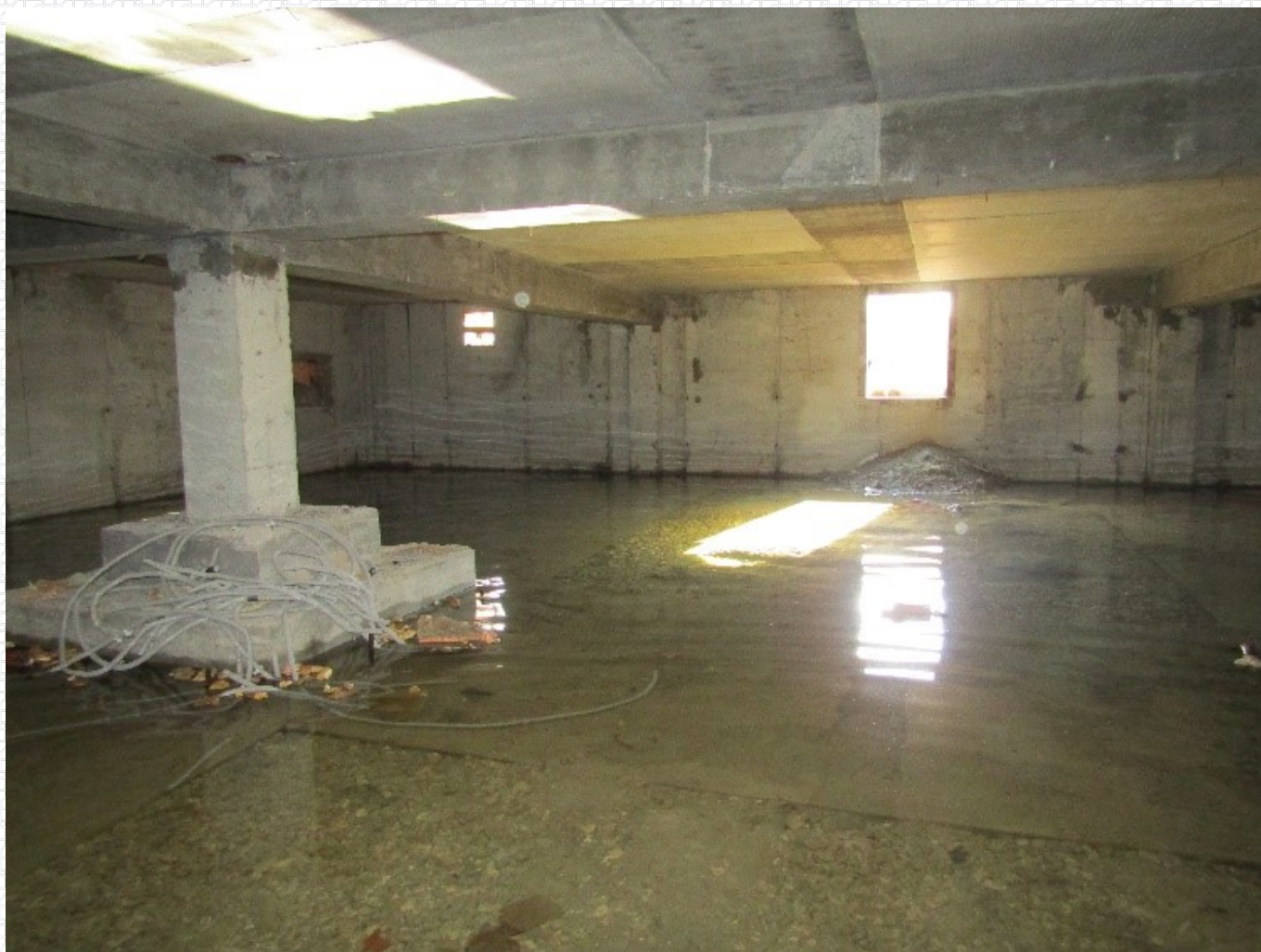
Рис. 1. Затопление подвала строящегося здания.
