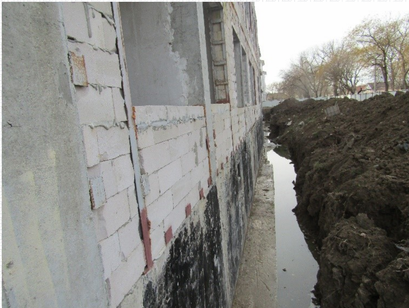
Рис. 2. Затопление цокольной зоны строящегося здания.
