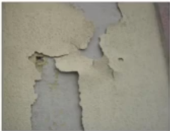
Гидроудар, акриловая штукатурка по каменной вате
